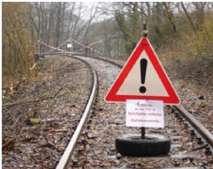
Die Brücke in Denklingen wurde aufgrund maroder Holzböhlen auf dem Randweg gesperrt. Die von der Kommune auf der Strecke aufgestellten Schilder sind schon originell, schließlich handelt es sich um eine Eisenbahnstrecke und nicht um einen Wanderweg. Der Bohlenweg ist als Rettungsweg mangels Regelverkehrs derzeit gar nicht notwendig. Foto: Ulrich Clees
