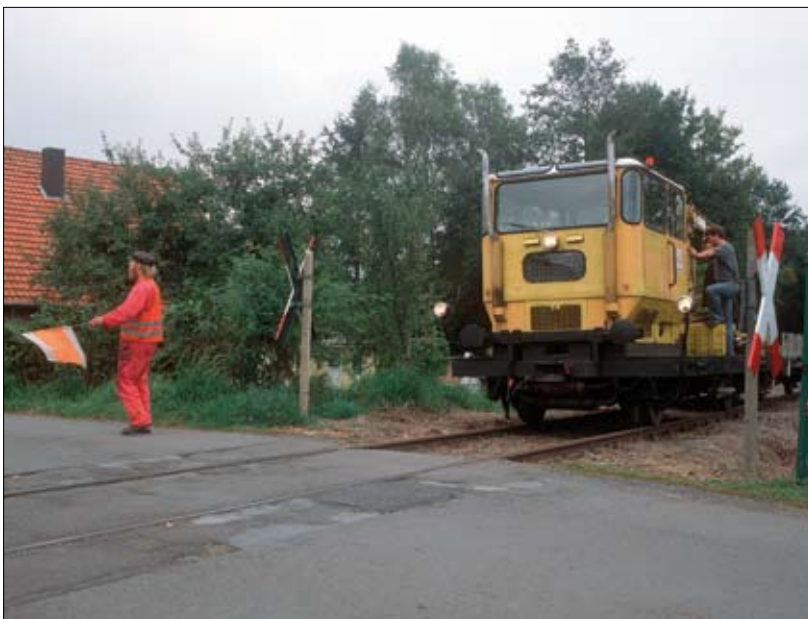
▲ Die Betriebseisenbahner der Rhein-Sieg-Eisenbahn sind im Oktober 2005 mit ihrem Kleinwagen auf der Wiehltalbahn unterwegs, um ihre Aufgaben zur Instandhaltung der Eisenbahninfrastruktur zu erfüllen. Fotos: Wolfgang Clössner
